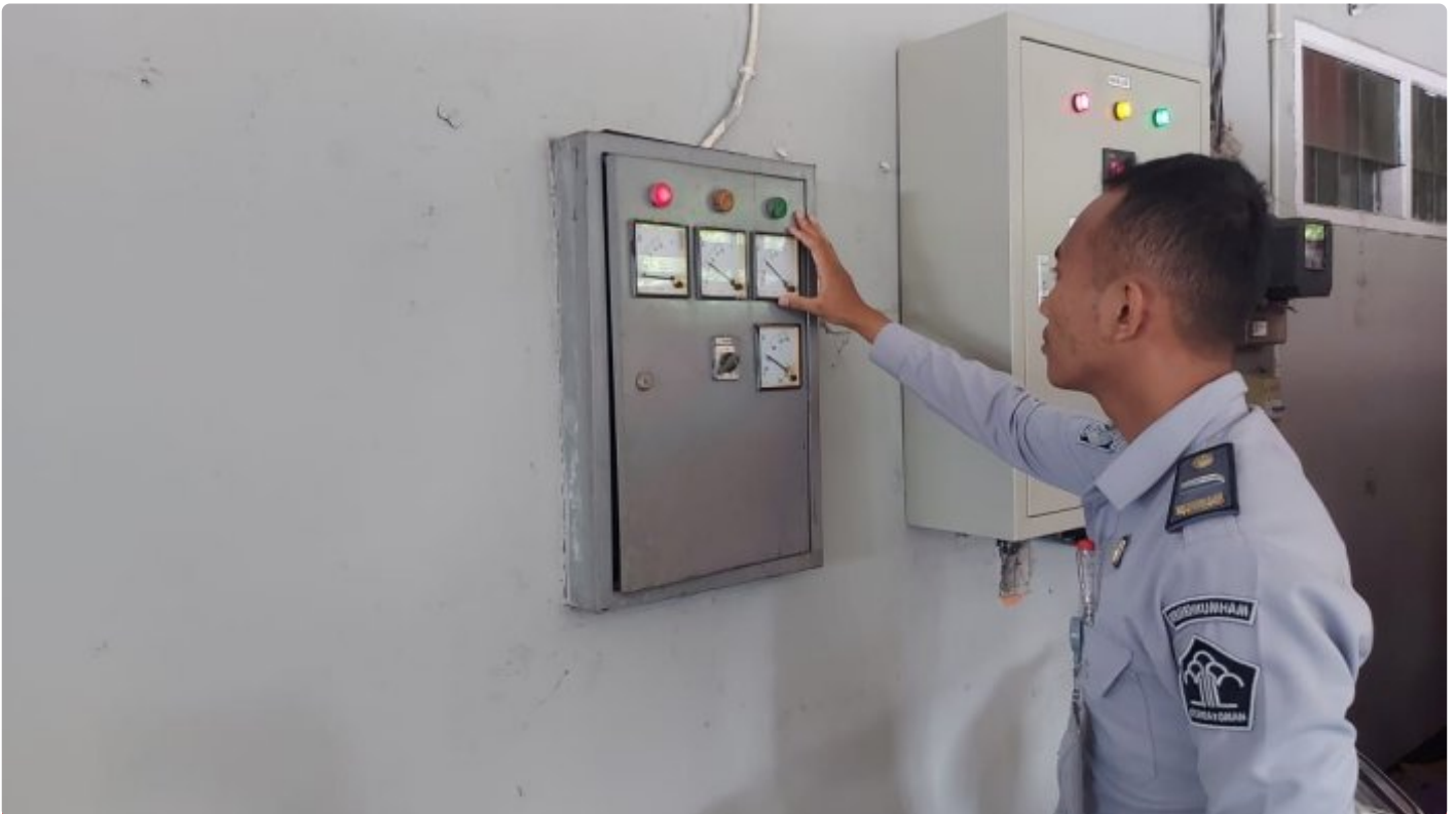
Cegah Konsleting Listrik, Pegawai Lapsustik Purwokerto Lakukan Pengecekan Panel Listrik
